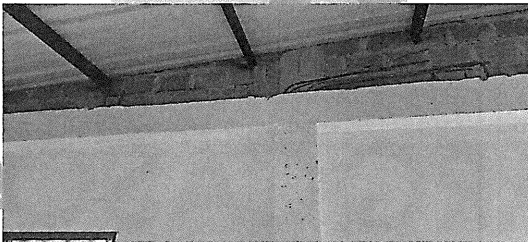
Foto 4. Franja superior del muro en ladrillo, sin confinamiento, bajo la cubierta metálica.
